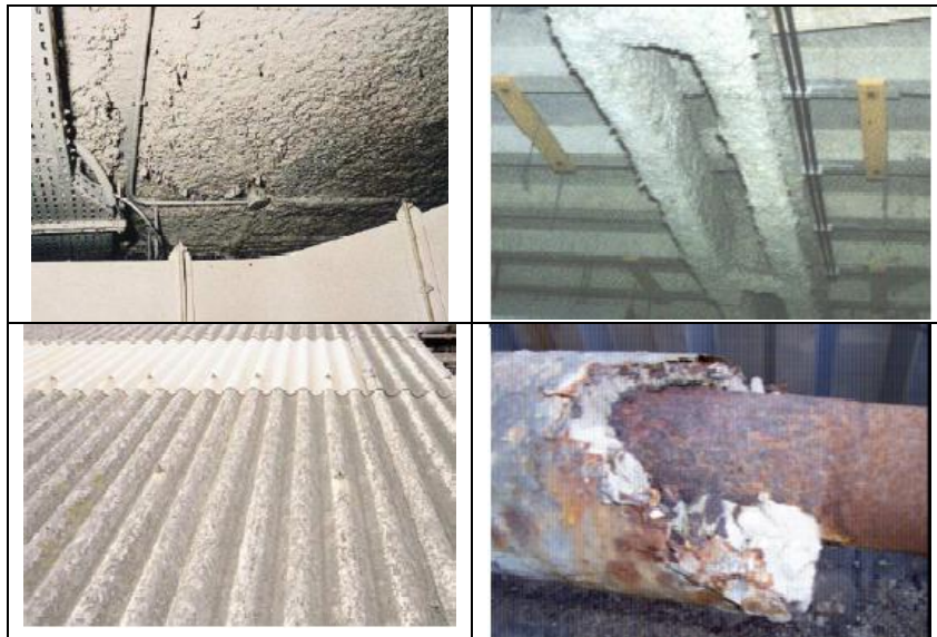
Imagen 3: Materiales que contienen amianto
