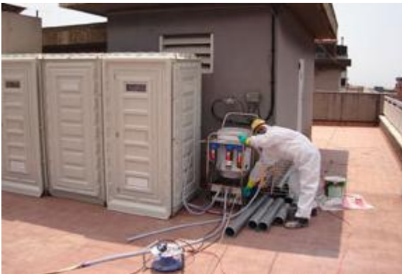
Figura 5: Cámaras de descontaminación
