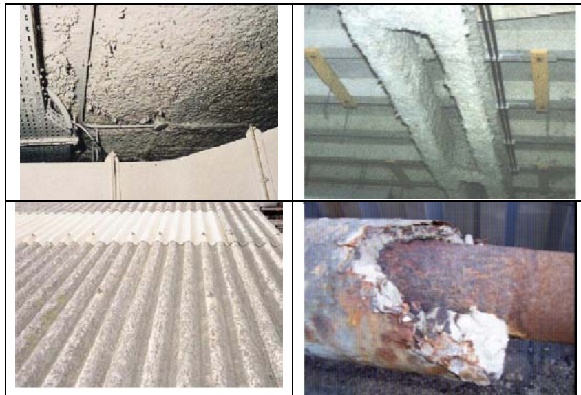
Imagen 3: Materiales que contienen amianto
