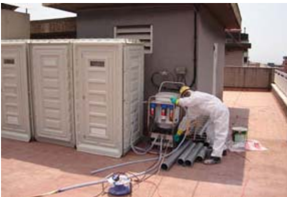
Figura 5: Cámaras de descontaminación
